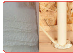
Aislamiento acústico y térmico
